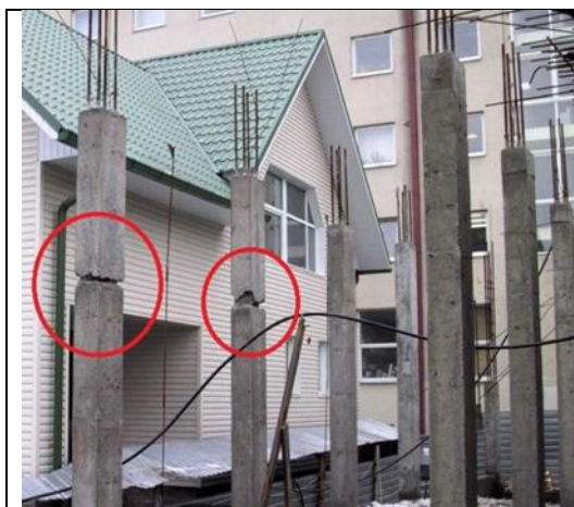
Рисунок 3. Пустоты в теле бетона колонны из-за некачественной уборки наледи перед бетонированием в зимнее время
