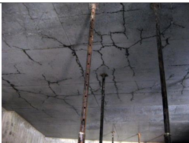
Рисунок 4. Трещины в плите перекрытия, возникшие при деформации от ранней распалубки и от пластической усадки бетона.
