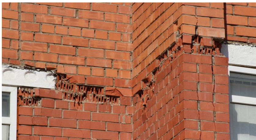
Фотофакт – 2. Фрагмент фасада жилого комплекса сданного в эксплуатацию в 2009 году: 1-смятие и выпор облицовочного, многощелевого, керамического кирпича имеющего марочную прочность 105 кгс/см 2 , тогда как по проекту должно быть 150 кгс/см 2 . Явно видно формальное функционирование входного контроля качества лицевого кирпича.
