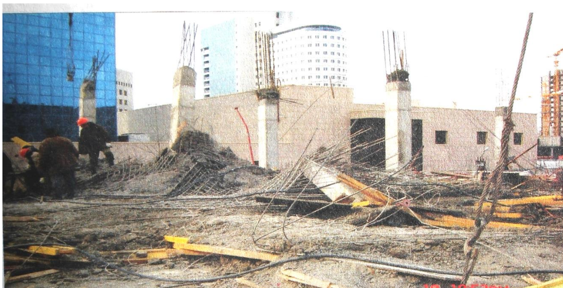
Фотофакт – 3. Фрагмент монолитного железобетонного каркаса технического этажа бизнес-центра «С-Петербург», где произошло обрушение опалубочной системы для бетонирования плиты перекрытия не прошедшей входного контроля качества.
