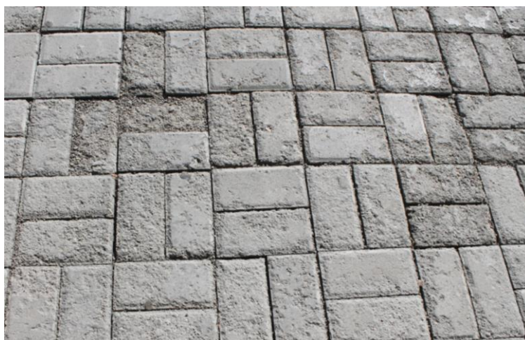
Фотофакт – 1. Фрагмент покрытия тротуара бетонной брусчаткой. 60% бетонной брусчатки не соответствует ГОСТ., что говорит о формальном функционировании входного контроля качества бетонной брусчатки.
