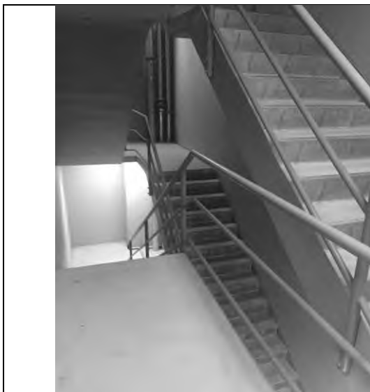
Рис.3. Слабо освещенные лестницы
