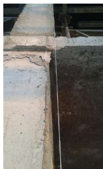
Рисунок 7. Несоосность колонн по высоте здания вследствие отсутствия должного геодезического контроля.
