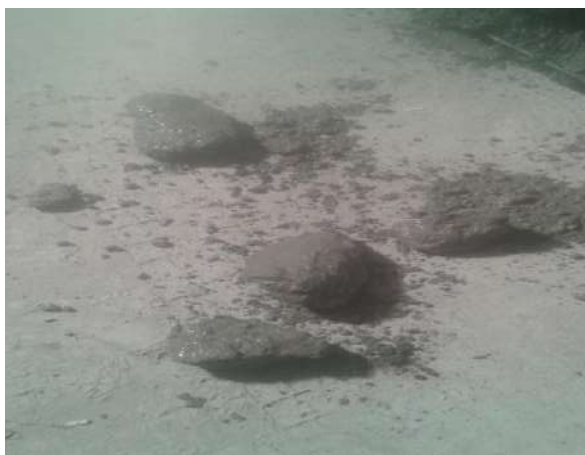
Рисунок 8. Наличие в бетонной смеси камней, фракцией до 150мм.
