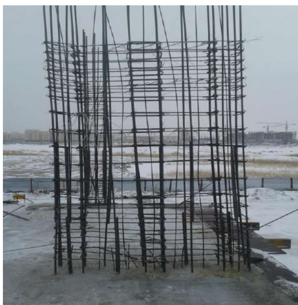
Рисунок 6. Нарушено расстояние между
