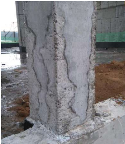
Рисунок 1. Множественные раковины в бетоне колонны.
