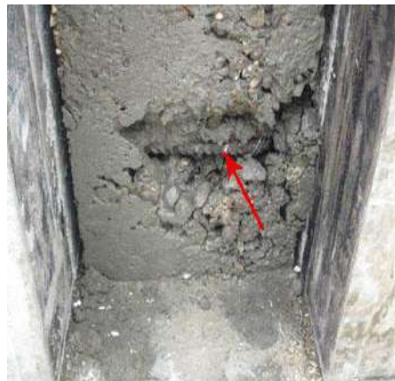
Рисунок 9. Большие камни застревают между арматурными стержнями, препятствуя прохождению бетонной смеси.
