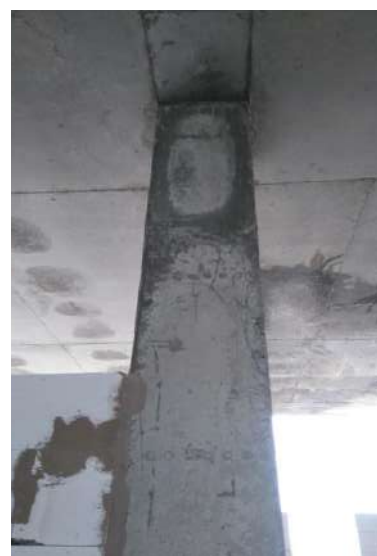
Рисунок 5. Замерзший бетон верхней части колонны.
