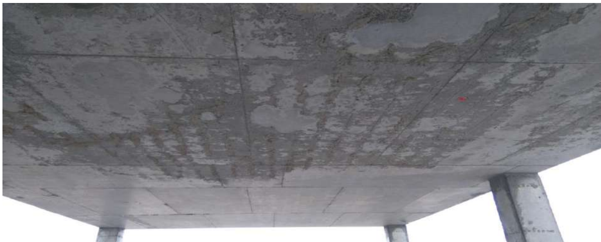
Рисунок 3. Множественные трещины на нижней поверхности плиты покрытия.
