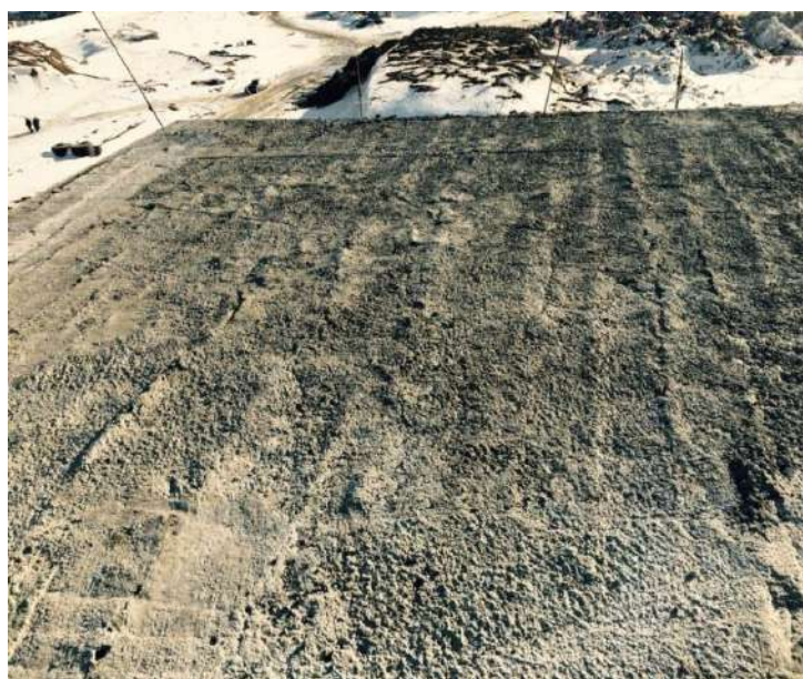
Рисунок 4. Замораживание бетона плиты покрытия.
