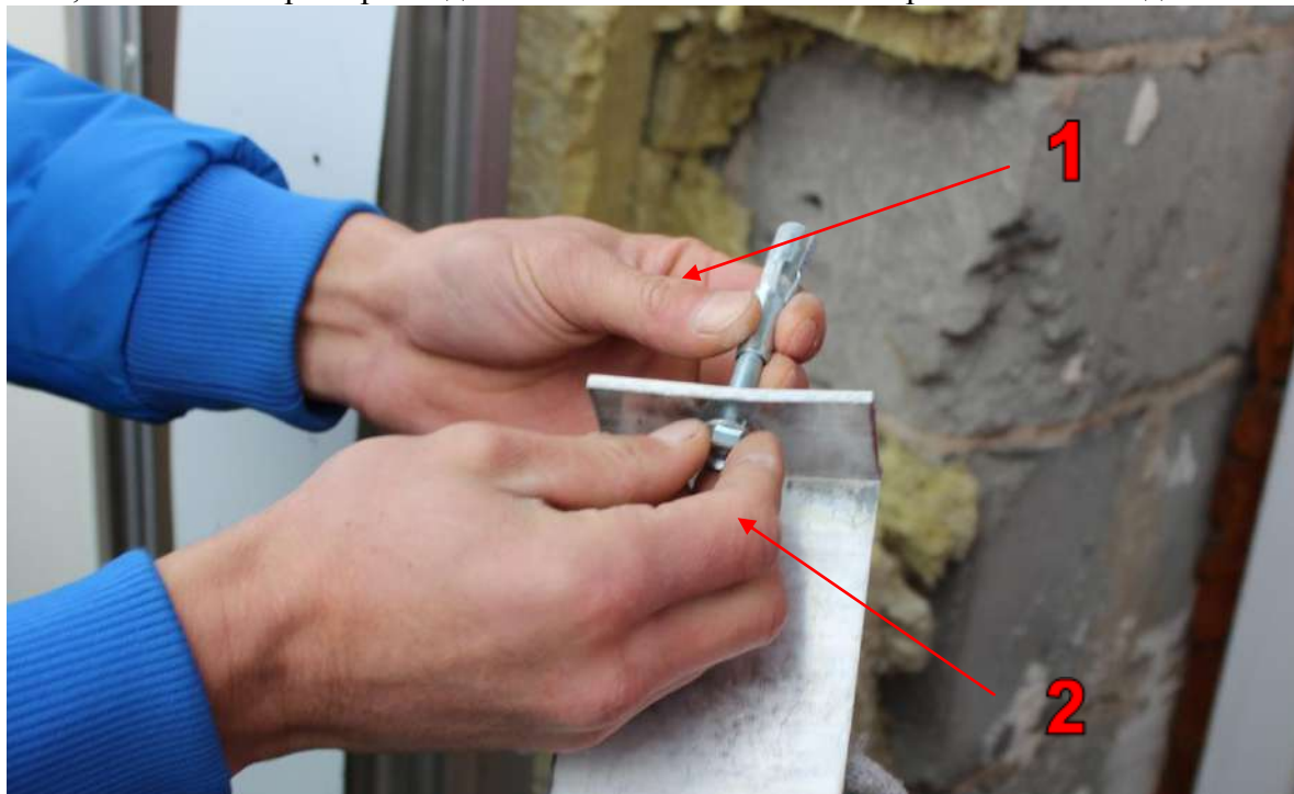
Фотофакт – 4. 1–распорный болт вместо длинной шпильки; 2 – кронштейн демонтированный.
