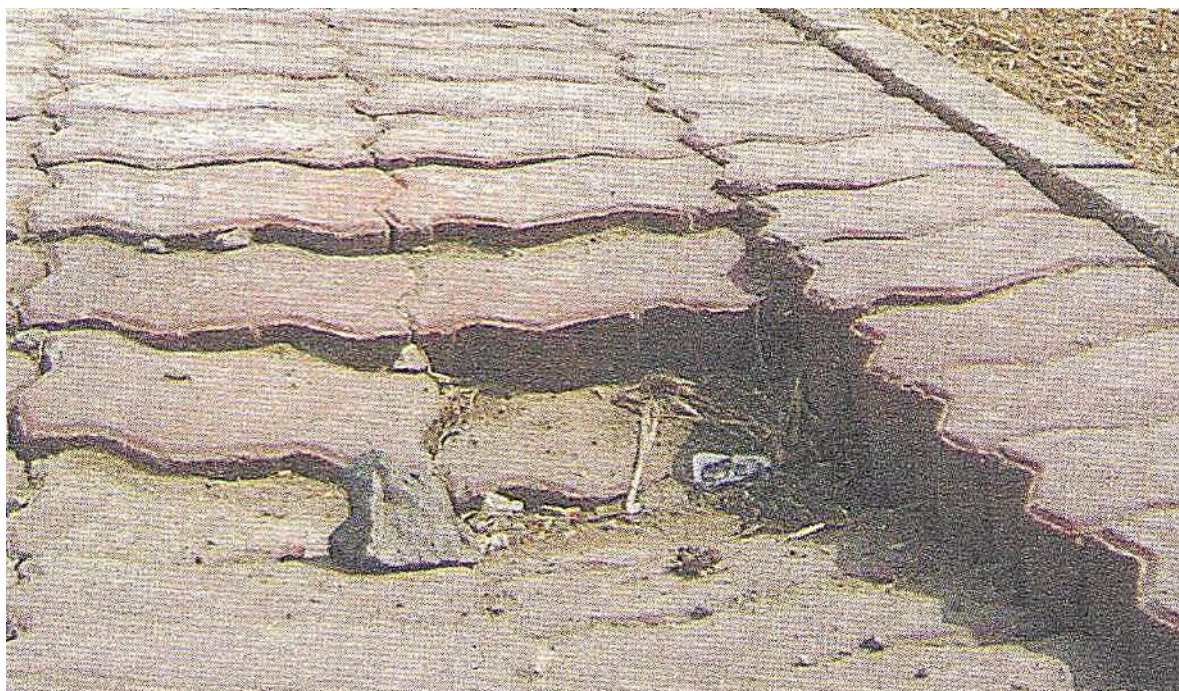
Рис.4 -После первого ливня участок грунтового основания из просадочного суглинка просел, вслед осела песчаная подготовка и брусчатка.
