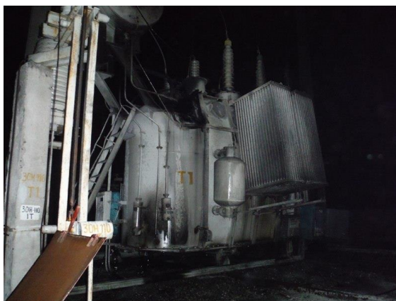
1-сурет. Жарылыстан кейінгі трансформатор, ҚС 110/35/10 кВ «Счетмаш» [5]
