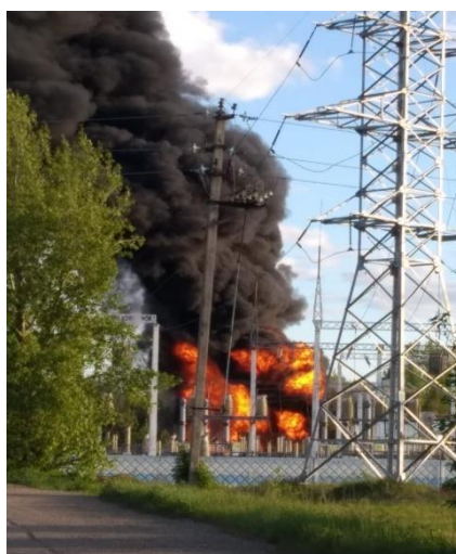
2-сурет. Трансформатордың өрттенуі
