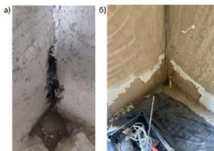
Рис. 5 а) заделка монтажного стыка в узле 1/Б пеной вместе гидроизоляции специальным составом: б) следы проникновения воды в углу пересечения осей 1/А из-за негерметичности вертикального монтажного шва
