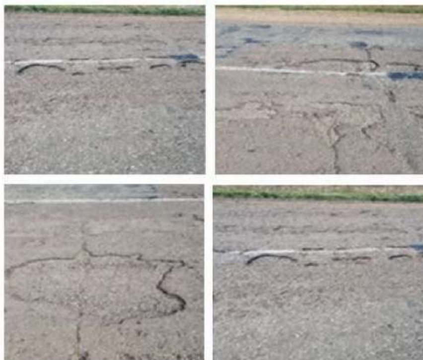
Рисунок 1.8 - Дефекты дорожного покрытия автомобильной дороги Р-2 «Энтузиаст (Ахметауыл) – Киевка (Нура)»
