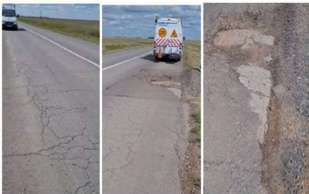
Рисунок 1.7 - Дефекты дорожного покрытия А-1 «Астана — Кабанбай
