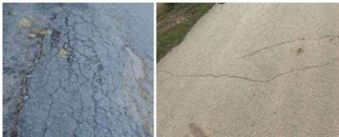
Рисунок 1.9 - Дефекты дорожного покрытия «Астана – Нура (Киевка) – Темиртау – Караганда»
