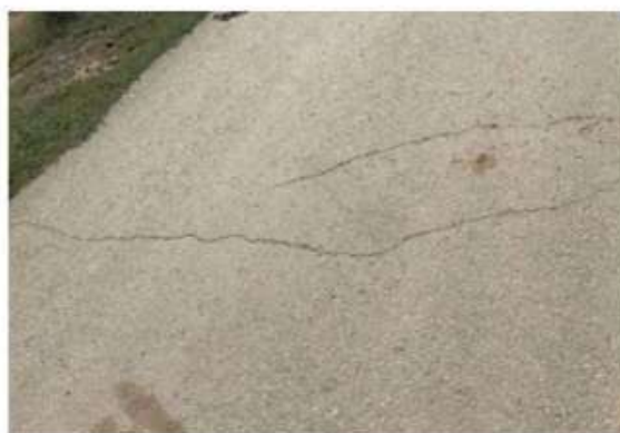
Рисунок 27 - Дорожное покрытия с дефектом
