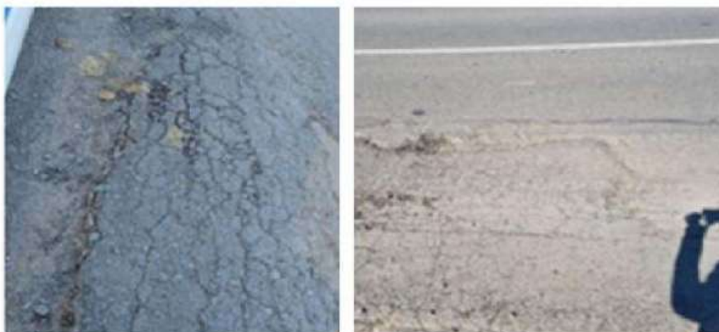
Рисунок 24 - Разрушения дорожного покрытия
