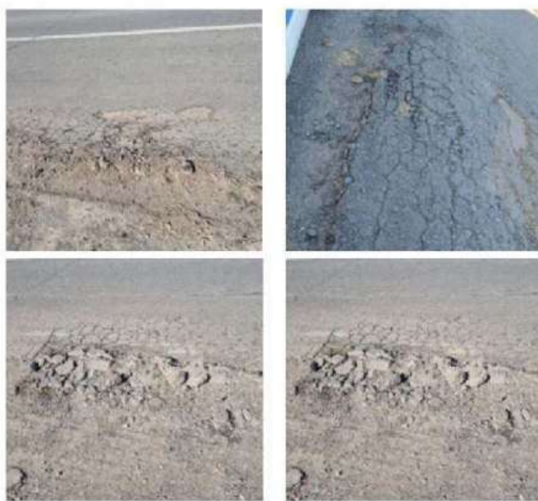
Рисунок 1.6 - Дефекты дорожного покрытия
