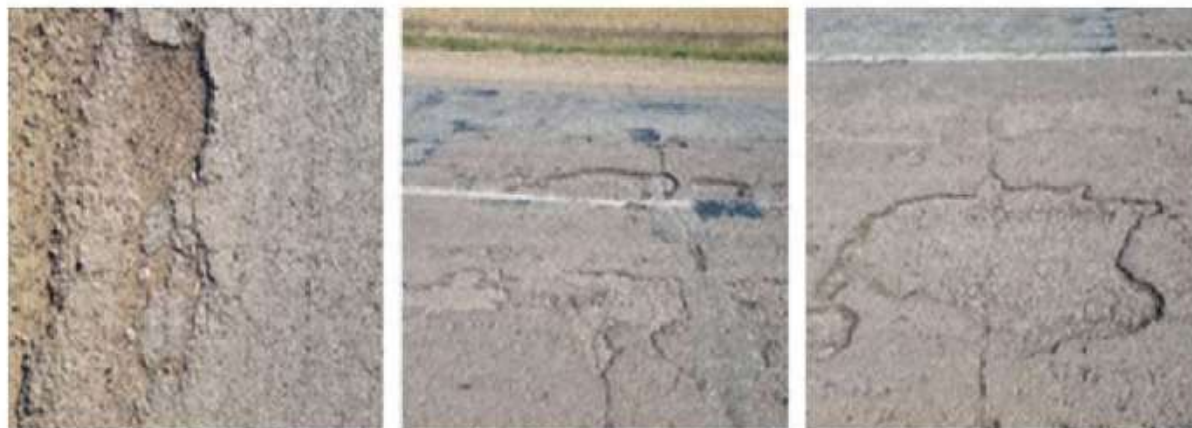
Рисунок 19 - Разрушения дорожного покрытия
