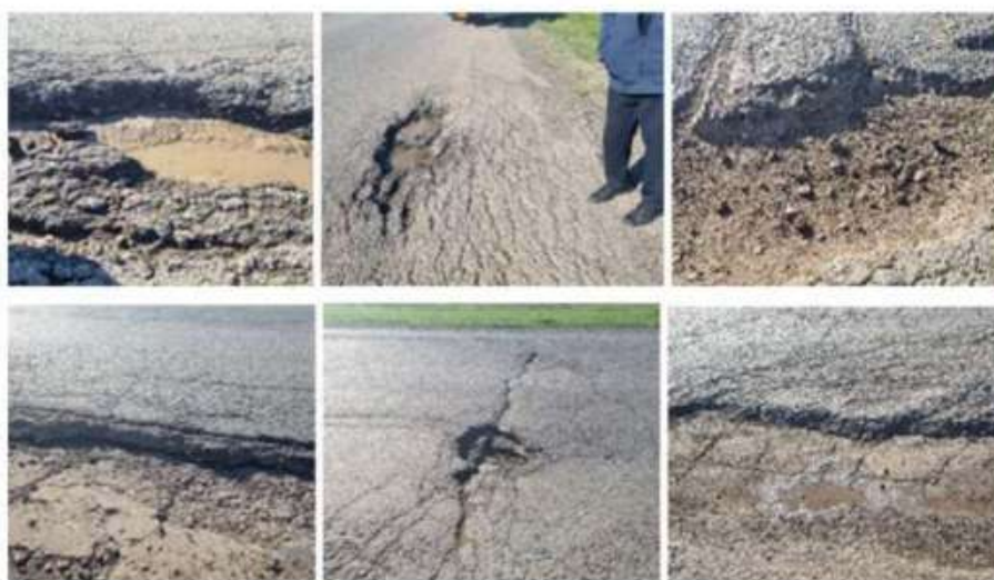
Рисунок 16 - Разрушения дорожного покрытия
